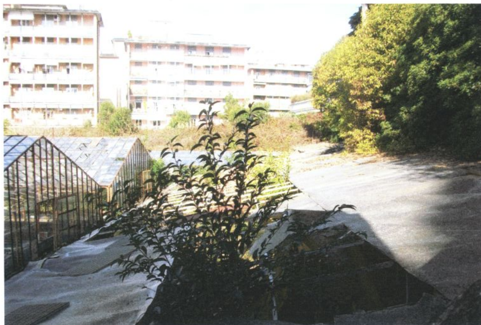
Foto 10: vista sulle serre fatiscenti
