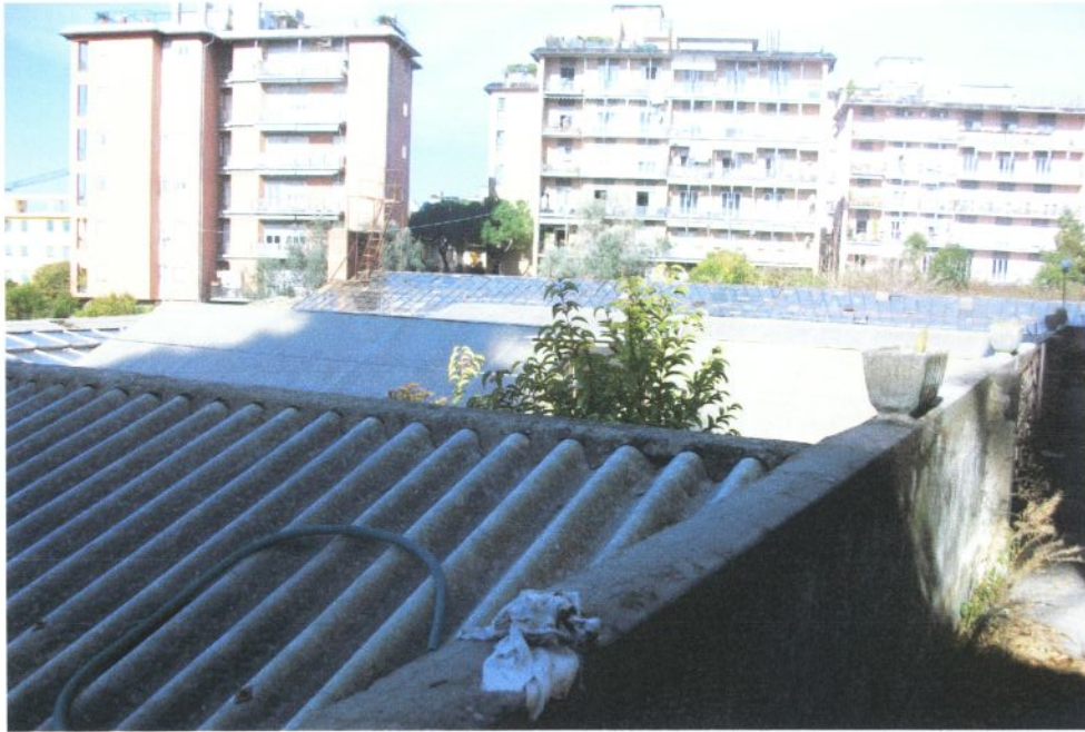
Foto 11: vista sulle serre fatiscenti
